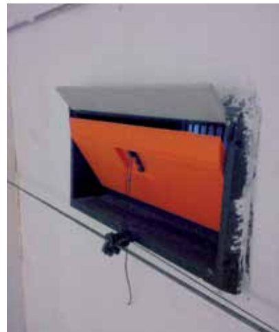
Otwory nawiewne to element wentylacji grawitacyjnej i podstawowy mechanizm wymiany powietrza w kurniku.
