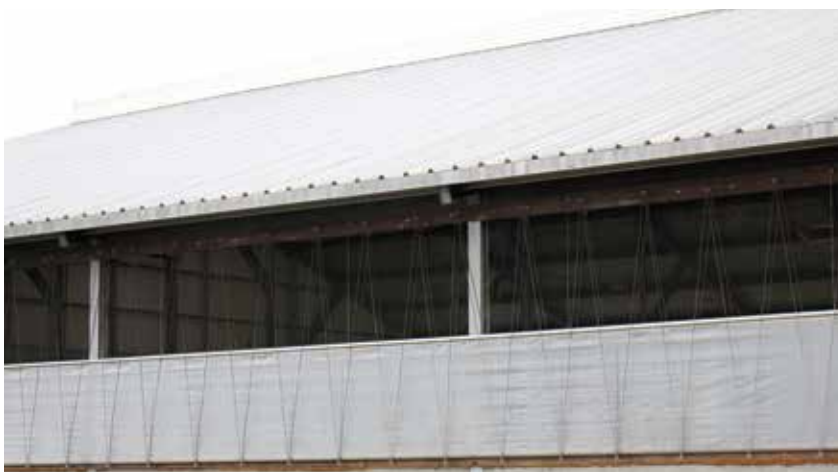
Kurtyny opuszczane automatycznie.
